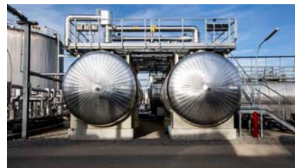
Wintershall hat in den letzten Jahren in die Modernisierung von Anlagen investiert.
